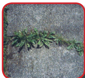
Les mauvaises herbes sur le trottoir avant traitement
